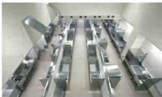
【参考】出展：仙台市HP南吉成学校給食センター調理室
