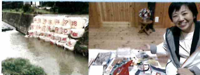
〈崩落した後田川の護岸〉 〈提供していただいた支援物資〉
