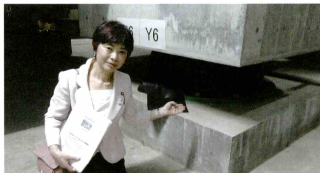
病院の躯体を守る免震装置
