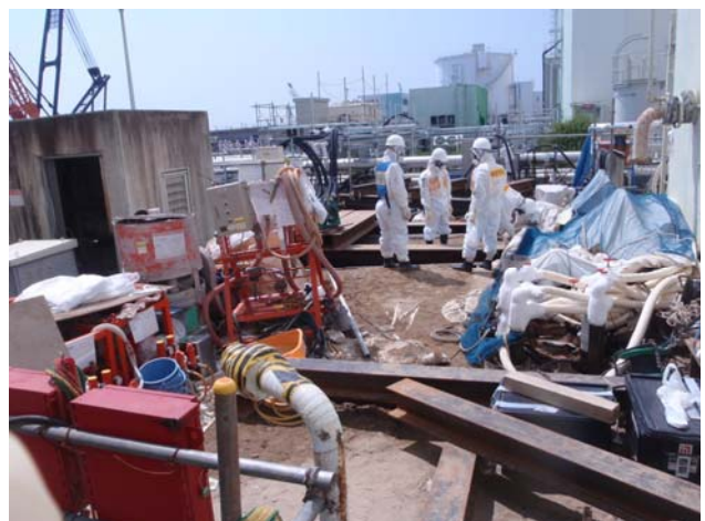
2号機海水配管トレンチ建屋接続部止水工事 (2号機立坑A地上部, 東京電力撮影2014.7.29)
